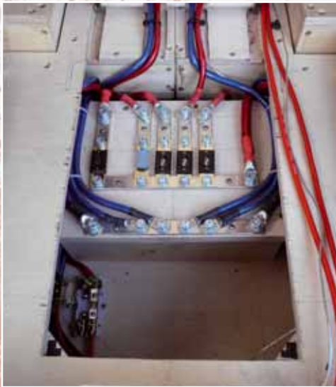
Hier wurde kein Wert auf Show, aber auf sorgfältige Verkabelung gelegt
