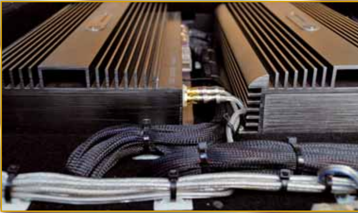
Unter der Verkleidung verbirgt sich die saubere Verkabelung der Kraftzentrale
